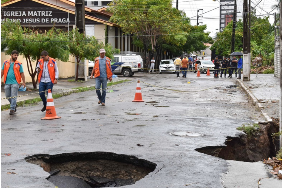
Crateras abertas nas ruas do bairro do Pinheiro.
