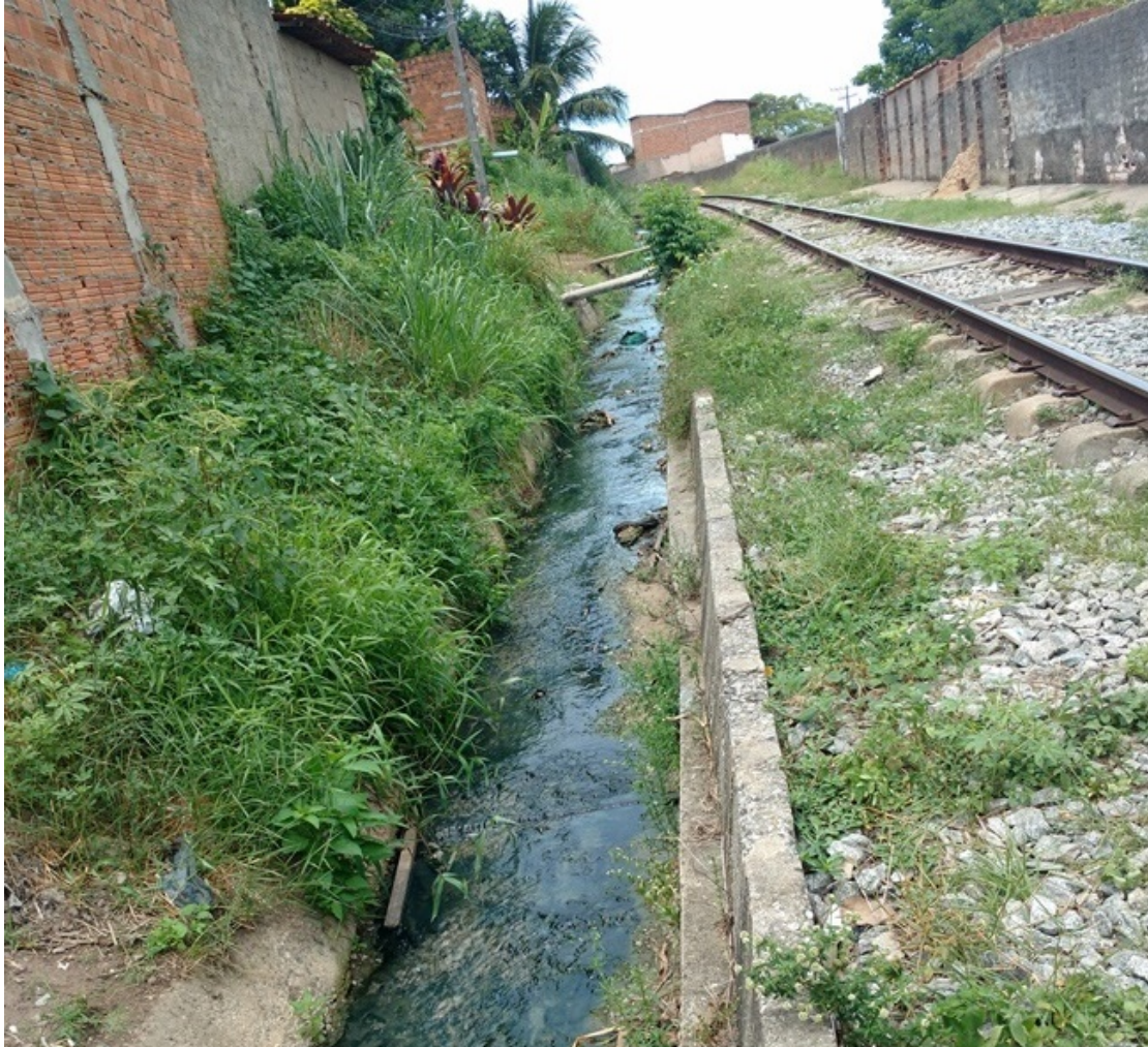
Esgoto a céu aberto no bairro do Mutange, em Maceió.
